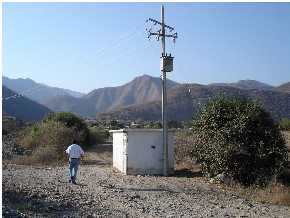
Fotografía 4. Pozo P-1 (Al fondo se observa el Poblado El Nuevo Caracol)
