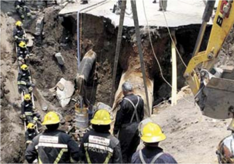
Imagen IV.2 Ruptura de los ductos de PEMEX por subsidio del terreno. (5 de julio del 07).
