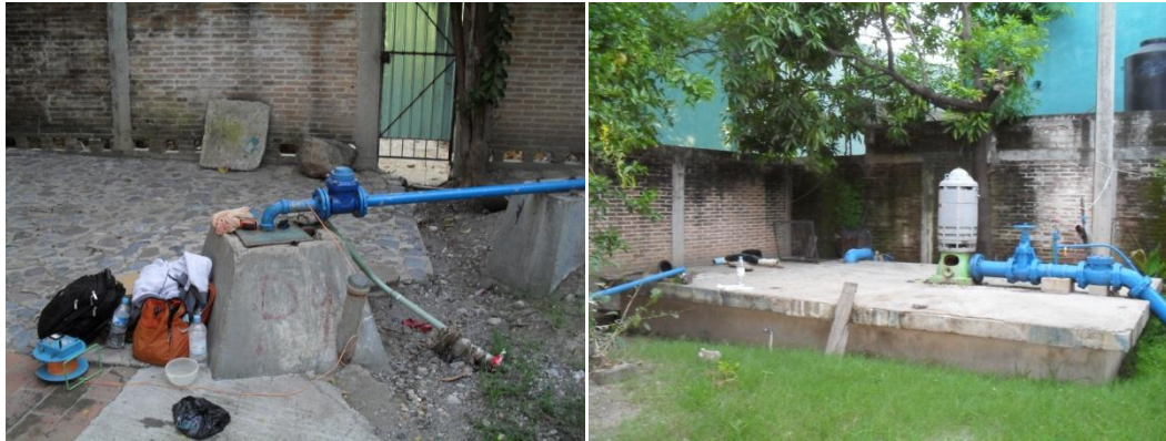
Figura 2.9 Pozo 9 con cisterna y rebombéo en la ciudad de Iguala, Guerrero.
