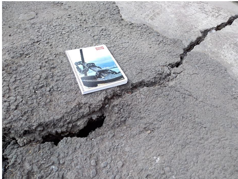
• Figura 31. Grieta con profundidad de 48 cm.
