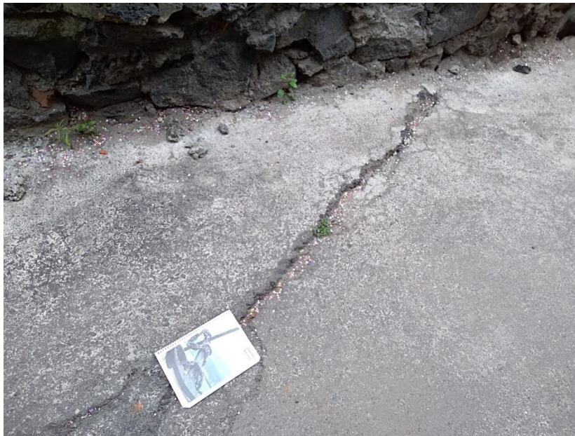
• Figura 26. Grieta con orientación 247^{\circ}
