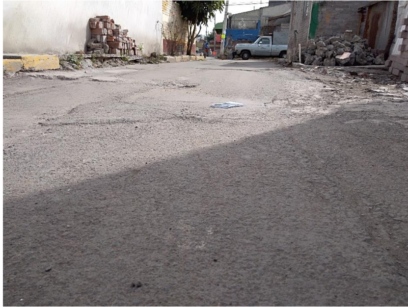
• Figura 30-4. Calle con hundimiento diferencial.
