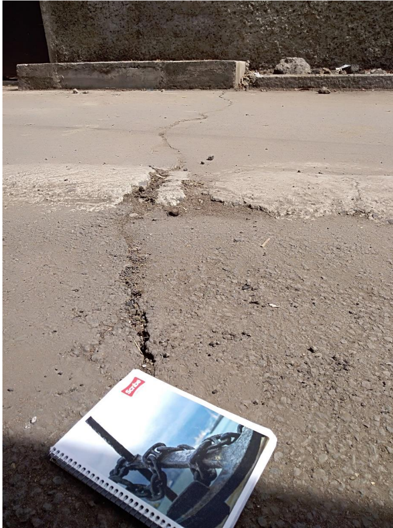
• Figura 33. Grieta con apertura de 3 cm.
