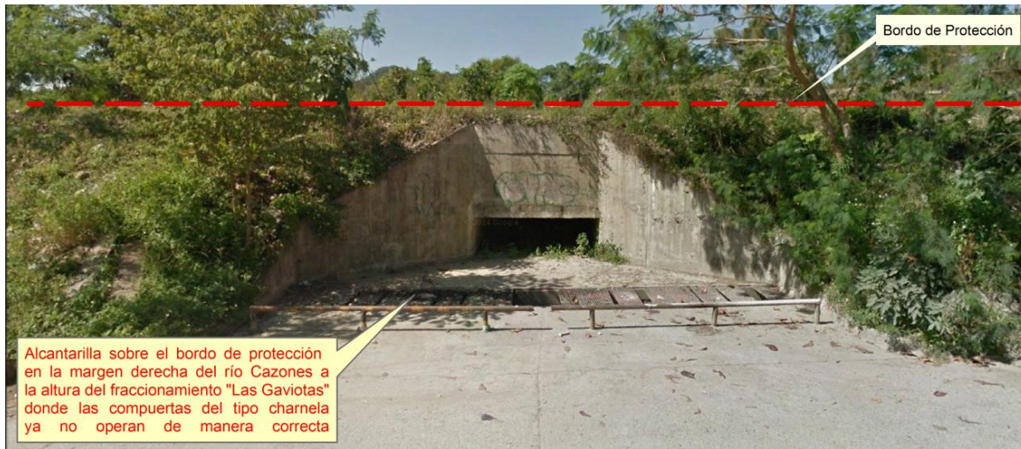
Figura 6. Se observa una de las alcantarillas que cruzan el bordo de protección de la margen derecha del río Cazones a la altura del fraccionamiento Las Gaviotas; las cuales no operan de manera correcta.
