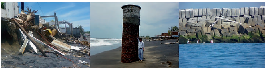
Figura 6. Evidencias de daños y cambios que ubican de alto y muy alto riesgo costero el área a (comunidad de Puerto Madero) de las playas del municipio de Tapachula, Chiapas. Imágenes tomadas de Castro-Castro (2018).
