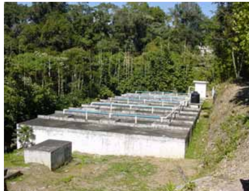
Foto 5. Planta de tratamiento de agua residual municipal.
