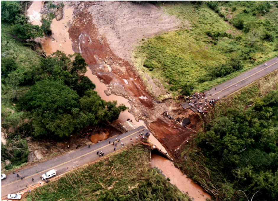
Foto 5. Puente fracturado por Stan en San Miguel, municipio de Acayucan (foto cortesía de la Subsecretaría de Protección Civil del Gobierno del Estado).
