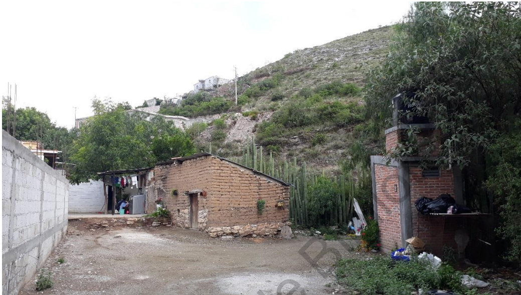
Figura 6. Los cuartos de adobe a inicios del siglo XXI. Silverio Muñiz, Charape de los Pelones, julio de 2018.
