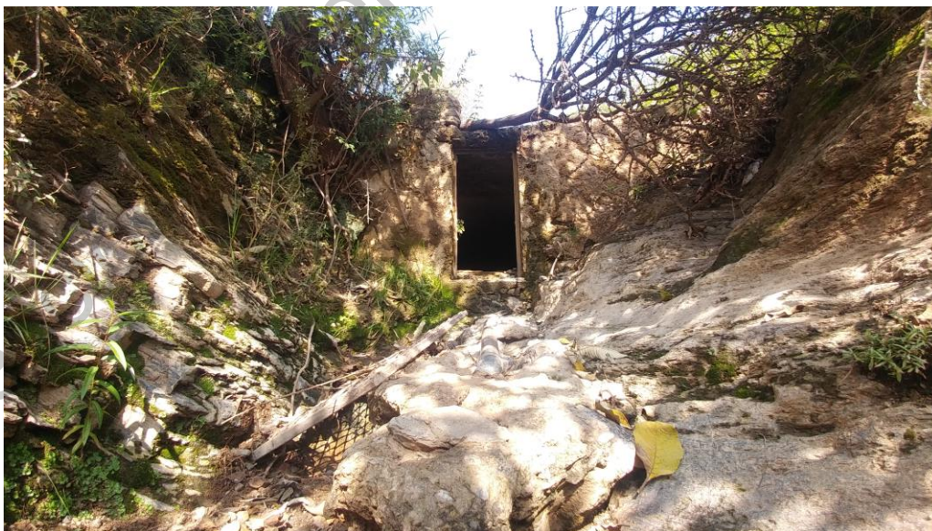
Figura 22. Pozo de abastecimiento del Depósito Comunitario. Eunice Reyes, Charape de los Pelones, noviembre de 2019
