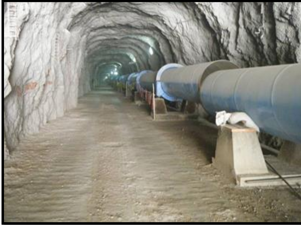
Ilustración 22.- Túnel que atraviesa el macizo rocoso de la sierra del Doctor. Fuente: http://www.banobras.gob.mx/casodeexito/Paginas/SistemaAcueductoIenQuer%C3%A9taro.aspx
