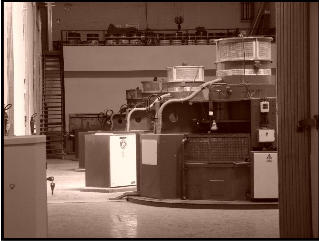
Ilustración 34.- Bombas de impulsión en Ojós, provincia de Alicante, España. Foto: Luis Enrique Granados Muñoz. Mayo de 2014. Color Sepia.
