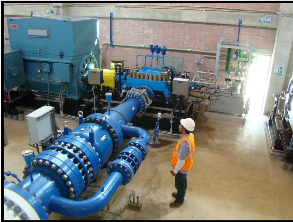
Ilustración 19.- Bomba de impulsión horizontal en el centro de bombeo 1. A un costado de la presa derivadora en el Río Moctezuma. Foto: Ernesto Granados Muñoz. Febrero de 2014.
