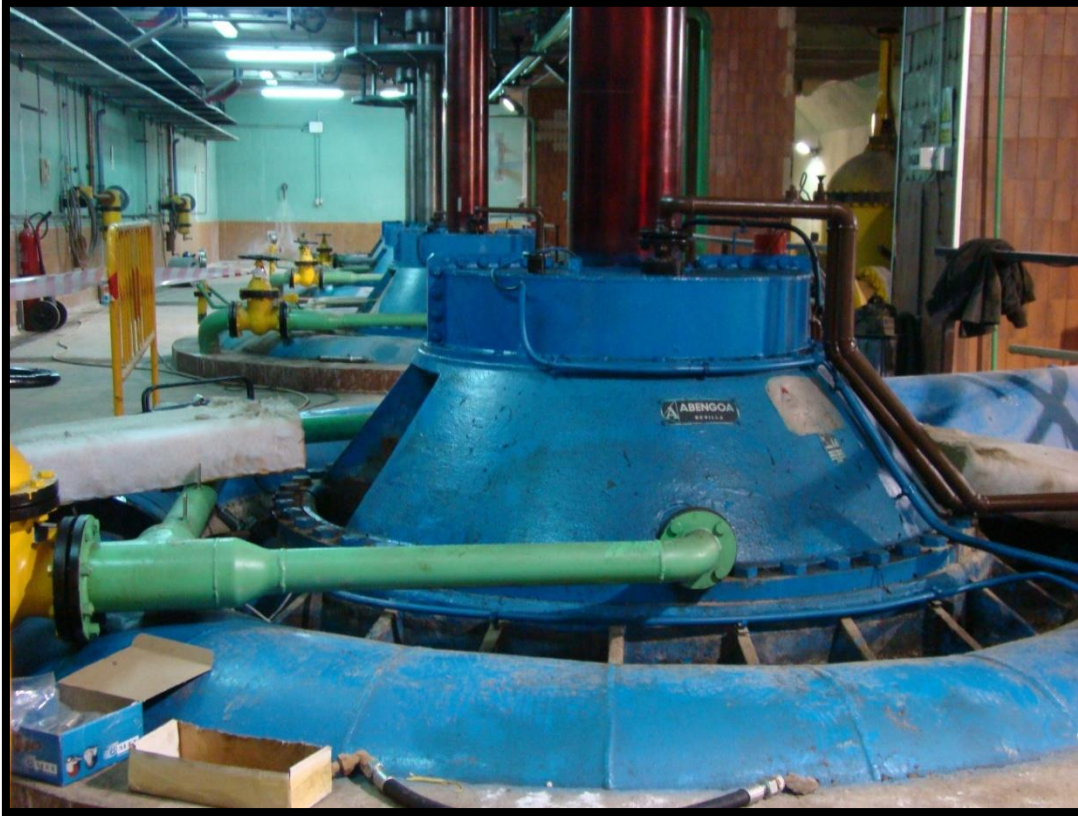
Ilustración 32.-Infraestructura para el bombeo de agua en una de las impulsiones del trasvase Tajo-Segura. Foto: Luis Enrique Granados Muñoz. Abril de 2014. Provincia de Alicante, España.
