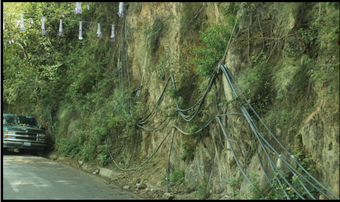
Ilustración 26.- Agua en mangueras desde el manantial de El Maconí abasteciendo a la cabecera delegacional. Foto: Morel Luna. Septiembre de 2014.
