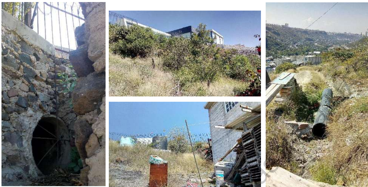
Ilustración 4.22 Punto de desagüe de El Campanario bajo cerca electrificada. Ilustración 4.23 Punto de desagüe detrás de vegetación. Ilustración 4.24 Casas de Santa María afectadas por las descargas de agua. Ilustración 4.25 Infraestructura adaptativa. Fotografías tomadas en noviembre 2018.
