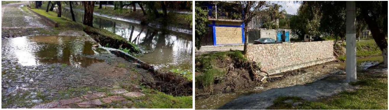
Ilustración 4.19 Punto de entronque entre las aguas tratadas y el cauce del río. Fotografía tomada en septiembre 2018 Ilustración 4.20 Infraestructura adaptativa. Fotografía tomada en septiembre 2018
