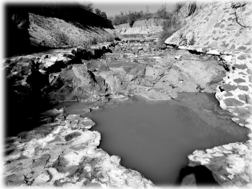
Figura 96. La huella de las aguas vertiginosas. Falla estructural en la plancha del dren justo donde se juntan las aguas recolectadas en El Refugio y La Pradera. Fuente: Fotografía propia.
