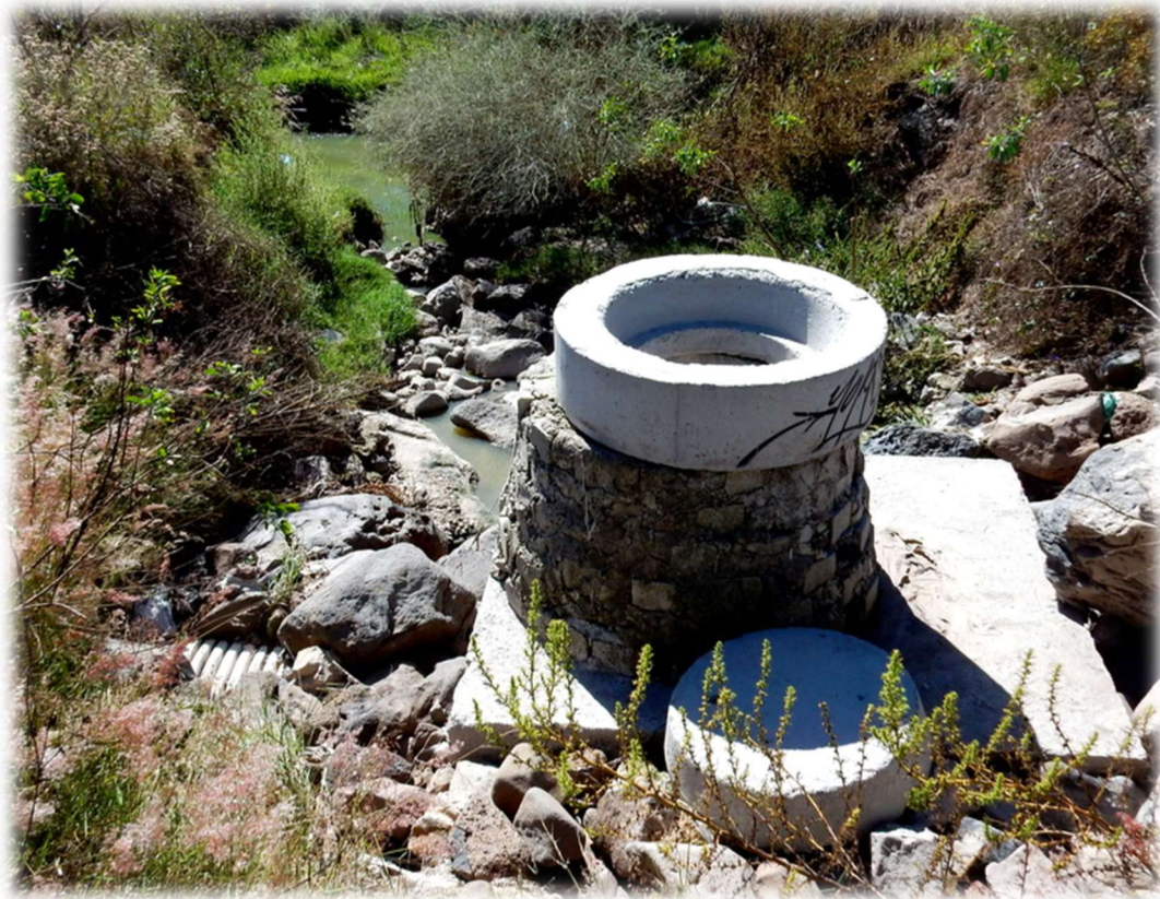
Figura 114. Paradojas del "Querétaro (pos)Moderno". Quiebre de infraestructura de drenaje en tierras de El Pozo. Fuente: Fotografía propia.
