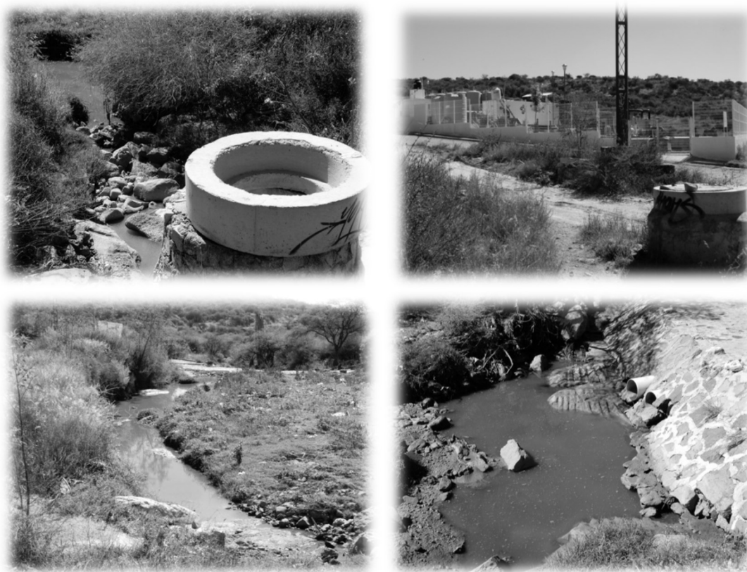
Figura 93. Fuga de aguas malas frente a la planta tratadora de El Pozo. Fuente: Fotografías propias.
