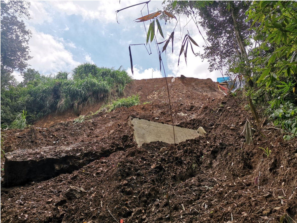
Ilustración 8. Deslave de talud del PLQS. Foto tomada el 27 de septiembre de 2021.
